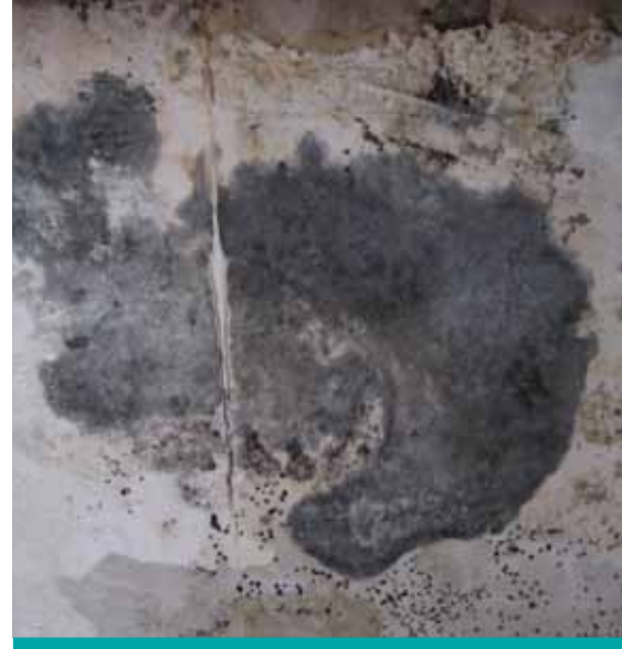
Eine großflächige und gesundheitsschädigende Schimmelpilzschicht hat sich hinter der Tapete gebildet.
